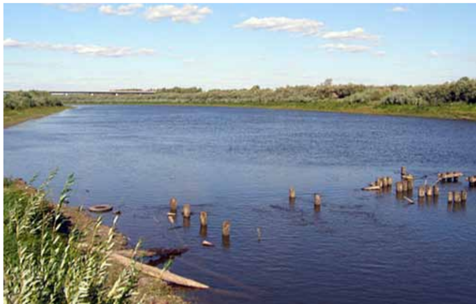
Сваи старого моста через р. Туру в г. Туринске
